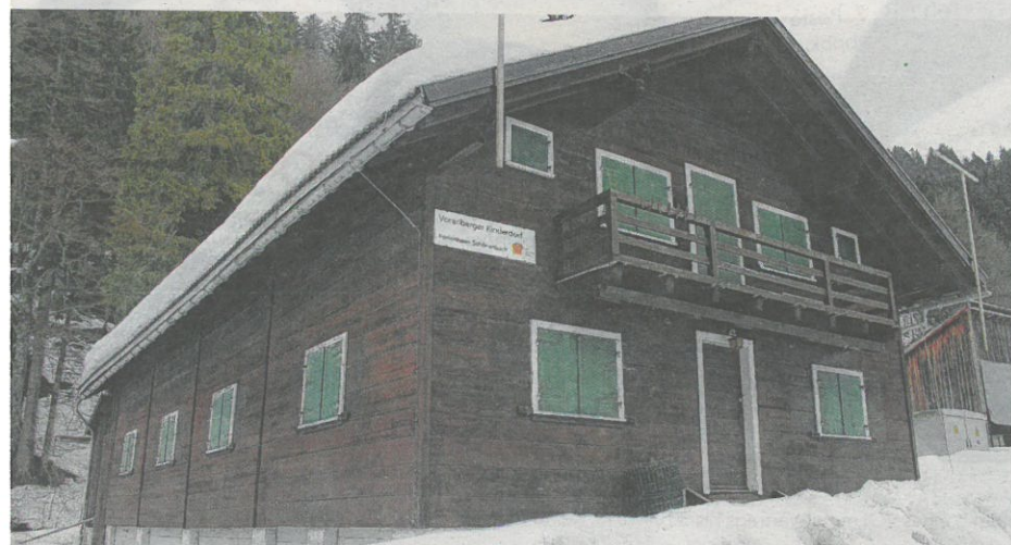
Die Bausubstanz des Haupthauses ist für eine Sanierung zu schlecht, deshalb wird das Objekt abgerissen und neu erstellt.
